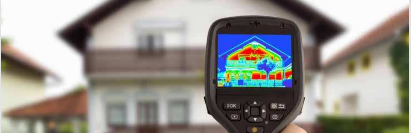
Die roten Stellen dieser Thermografie machen sichtbar, wo am Haus die Schwierigkeiten liegen und am meisten Wärme verloren geht.
